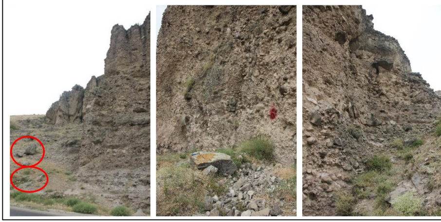
Şekil 6. Düşmüş kaya blokları
