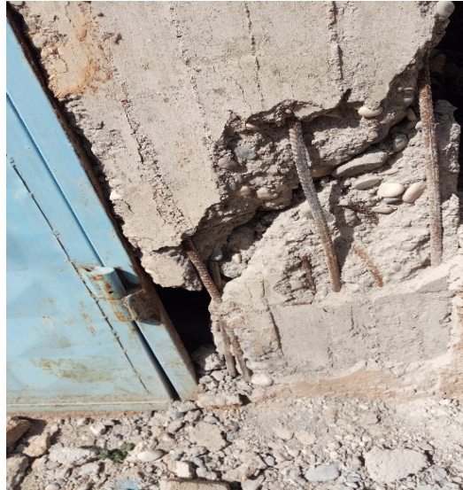
Şekil 8. Zemin Kat Kolon (etriye, eksik malzeme)
