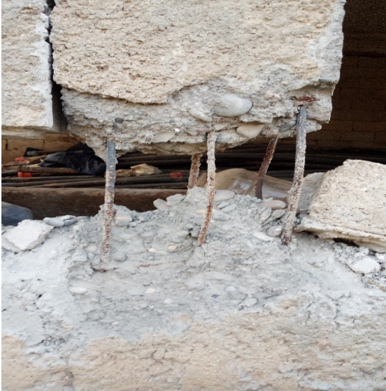
Şekil 7. Zemin Kat Kolon (eksik malzeme)
