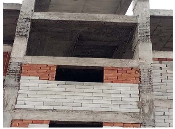
Şekil 5. Segregasyon (dış cephe kolonları)
