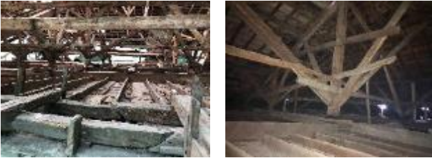
Şekil 4. Asma çatı, tavan kaplaması ve bozulmalar.
