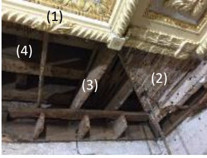
Şekil 9. Tavan katmanları; 1.Sıva ve alçı süsleme, 2.Bağdadi çıtalı, 3. Tavan kaplama kirişleri, 4. Çatı döşeme kirişleri.
