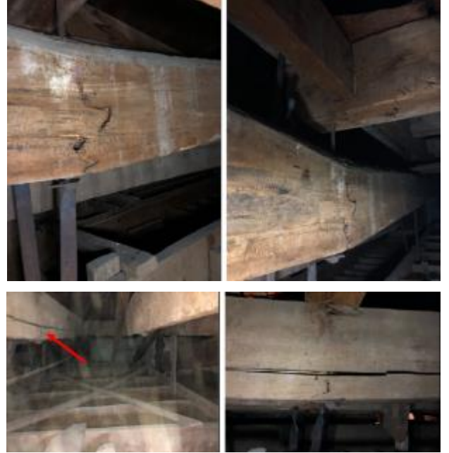
Şekil 12. Çatıda oluşan hasarlar.
