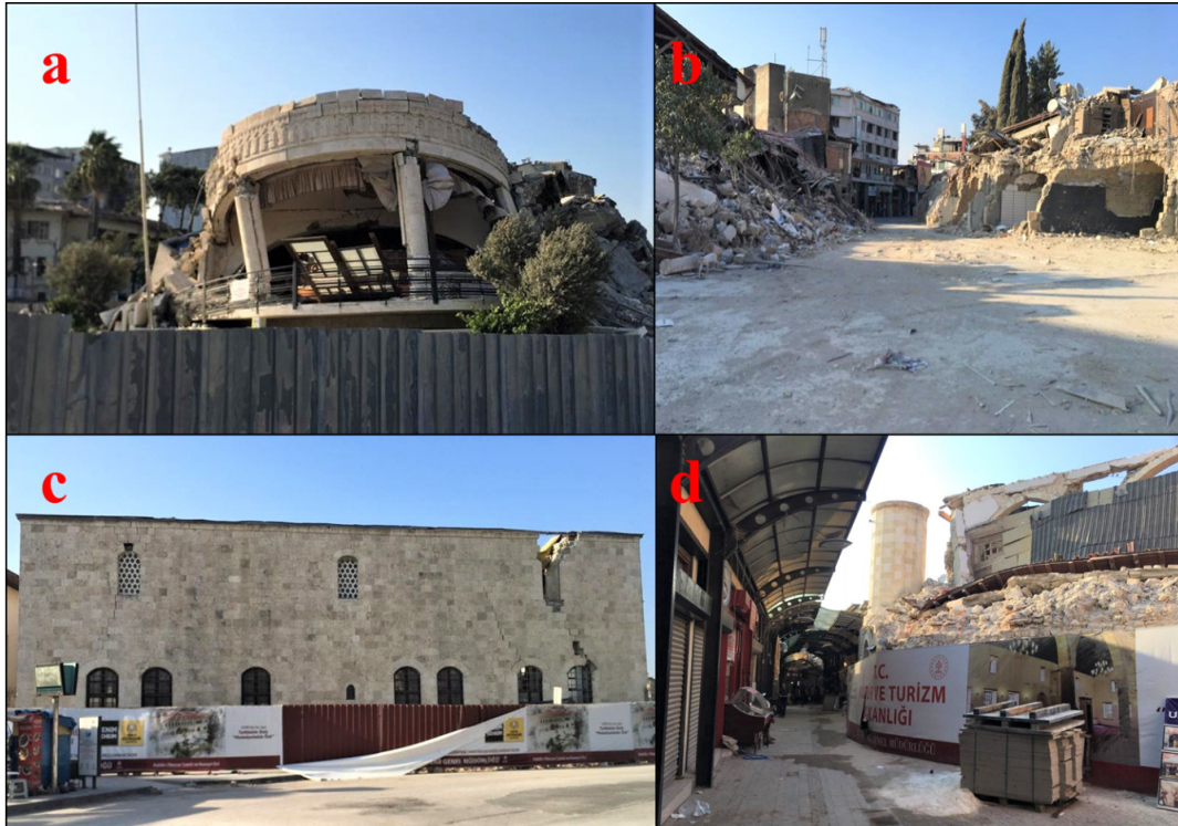
Fotoğraf 1. Depremler sonrasında ağır hasar alan Meclis binası (1a), Saray caddesi (1b), Habib-i Neccar camii (1c) ve uzun çarşıdan (1d) görünüşleri.
