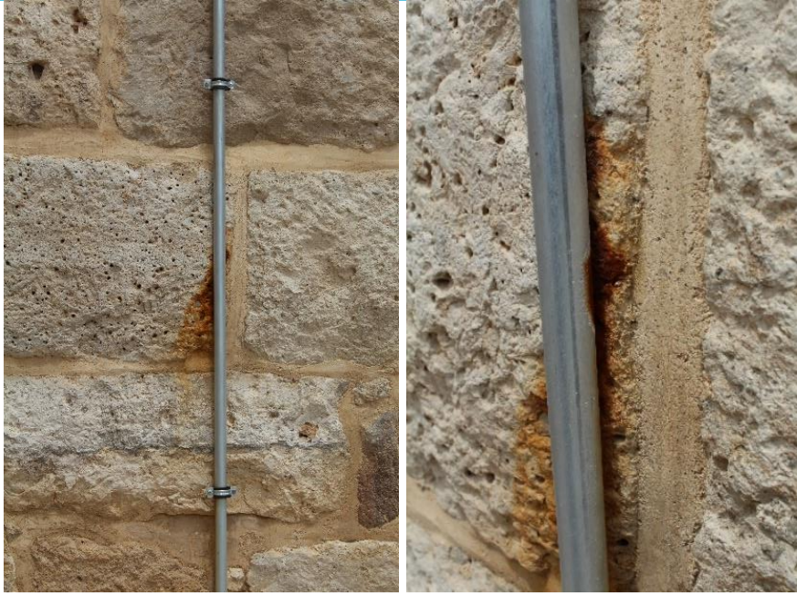
Fotoğraf 13. Taş yüzeyde meydana gelen korozyon – pas lekesi
