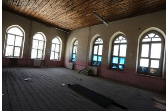
Şekil 27. Senirkent Turan İlköğretim Okulu birinci kat kuzeydoğu köşedeki oda (Kişisel arşivden)
