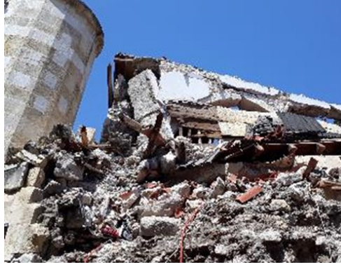
Resim 9. Uzunçarşı bölgesinde aynı duvar içerisinde kullanılan betonarme kolon, taş kemer ve yığma duvarın farklı çalışması sonucu oluşan yıkım (Yazar arşivi)
