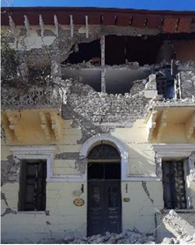
Resim 14-15. Kesme taş kaplama malzemesinin altında ortaya çıkan kötü malzeme ve duvar işçiliği kalitesine örnekler (Gökçe Türkoğlu ve yazar arşivi)
