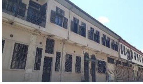
Resim 5. Deprem sonrası yapısal bütünlüğünü hasarsız olarak korumuş bitişik nizam yapı grubu (Yazar arşivi)
