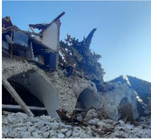
Resim 10. Saray Caddesinde tonozlu zemin kat üzerinde bulunan birinci kat ve çatıda zamanla yapılan kullanıcı müdahaleleriyle bozulan yapısal bütünlük (Yazar arşivi)
