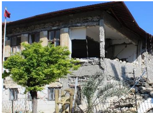
Resim 8. E.B.Teknik ve Meslek Lisesi'nde betonarme tasarımındaki kusurlar (Yazar arşivi)
