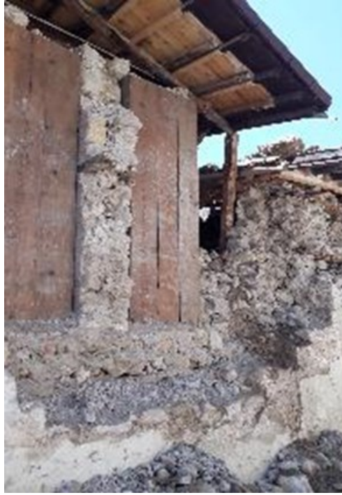
Resim 7. Duvar içerisine yerleştirilen dolaplar nedeniyle kesiti zayıflayan yığma duvar (Yazar arşivi)
