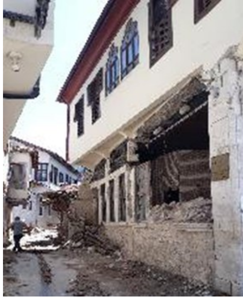
Resim 19. Antakya Kurtuluş caddesinde zemin kattaki açıklıklar nedeniyle oluşan yığma duvar miktarı yetersizliği ve yumuşak kat etkisi (Yazar arşivi)
