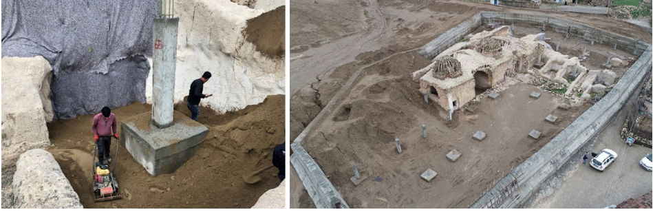
Fot. 13: Süleyman Han Külliyesi üzerine yapılan betonarme kabuğu taşıyacak kolonlar ve eş zamanlı mil dolgulama uygulaması (KVMGM arşivi; Sevgi ve Yılmaz, 2022,188)
