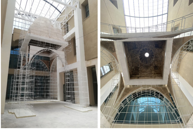
Fot. 10: a. Süleyman Han Külliyesi özgün alçı kubbesi çelik strüktüre montajı, b. Sunumu
