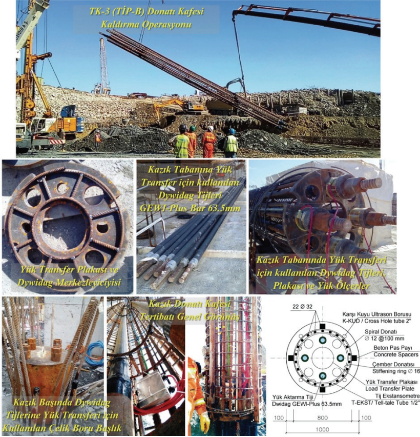
Şekil 4 - Enstrüman edilmiş TK-3 deney kazığı (TIP-B) donatı kafesi genel ve detay görünüşü.
