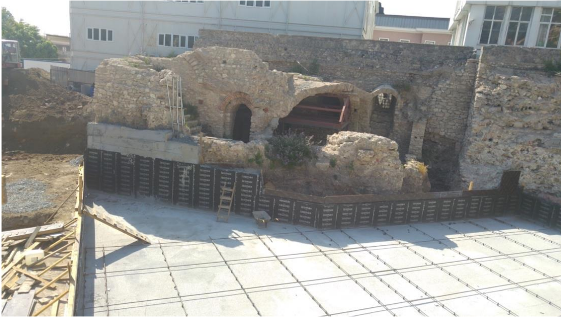
Şekil 6: İnşaat aşamalarında yatay hareketin sınırlandırılması için tarihi yapıya dıştan kuyu perde yapılmıştır (Neşe Karaçay, 2016)
