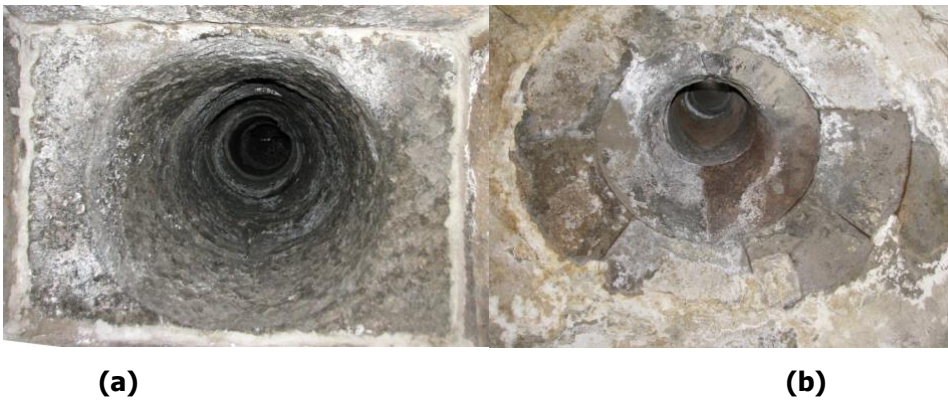
Şekil 15. Bitlis Eski Bitlis Belediye Binası; (a, b) Hela kubbe ve havalandırma menfez görünüşleri (Kaynak: (a, b) Çalışma kapsamında yazar tarafından oluşturulmuştur, 2012).
