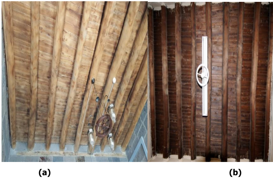
Şekil 37. Bitlis Eski Belediye Binası (a, b) İç mekân ahşap tavan onarım görünüşleri (Kaynak: (a, b) Çalışma kapsamında yazar tarafından oluşturulmuştur, 2012).
