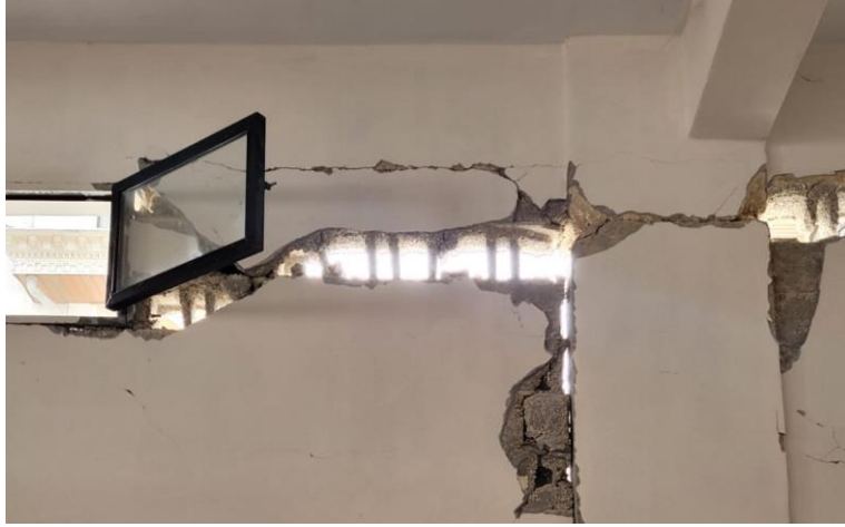
Şekil 9: Kısa kolon hasarı.
