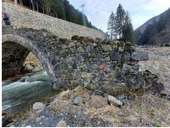
Foto. 51. Binatlı (Terzili, Cingalli) Köprüsü Yıkık Bölümleri (2024)
