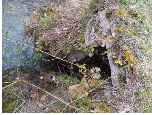
Foto. 39. Goballı Köprüsü Zarar Görmüş Bölümleri (2024)
