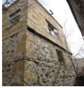
Şekil 21. Sofanın yer aldığı güneybatı cephesindeki kat silmesi
