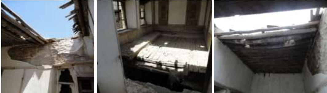
Şekil 26. Zemin ve tavan döşemesinde meydana gelen göçükler
