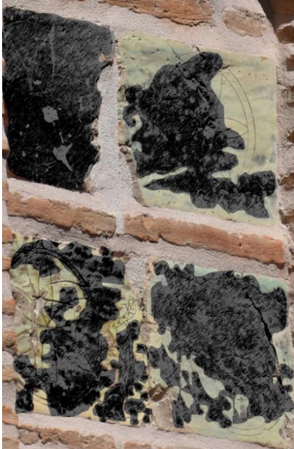
Görsel 21: Azize Ekaterini Kilisesi, güney duvardaki çinilerde bozulmalar (Siyahla taralı alanlar bozulmaları göstermektedir.)
