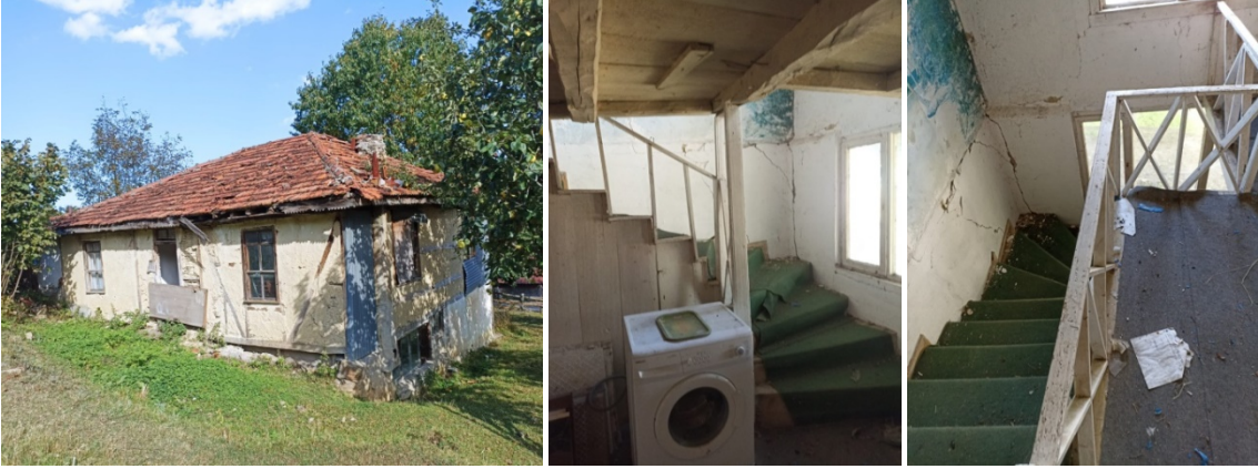
Görsel 27. Yapının terk edilmesi sonucunda ciddi derecede yapı içerisinde ve dışında çatlaklar, malzeme kayıpları gibi sorunların oluşması
