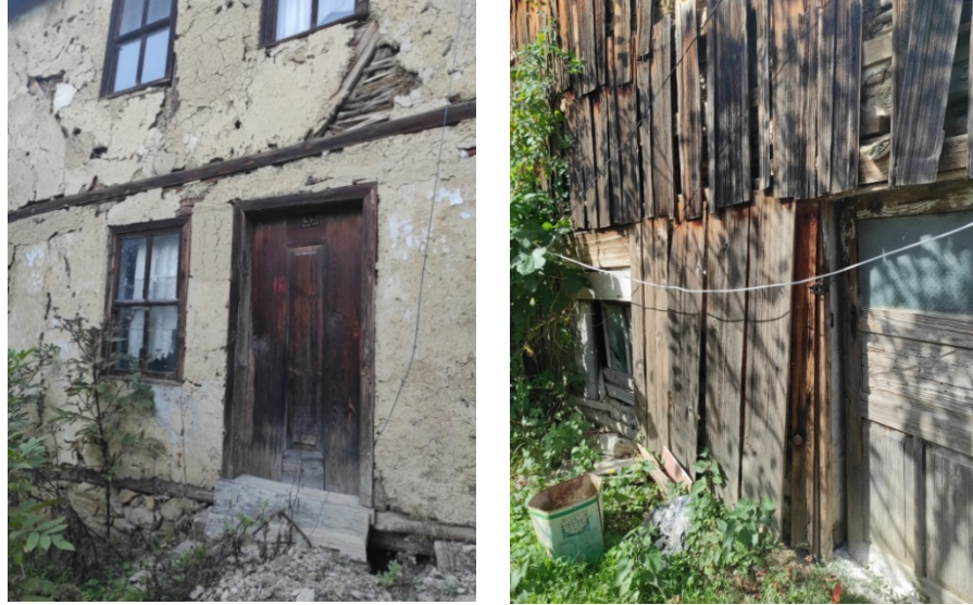
Görsel 28. Gereklili bakımlarının yapılmaması sonucu toprak sıvanın kopması, çatlaması ve ahşap malzemede oluşan kayıplar
