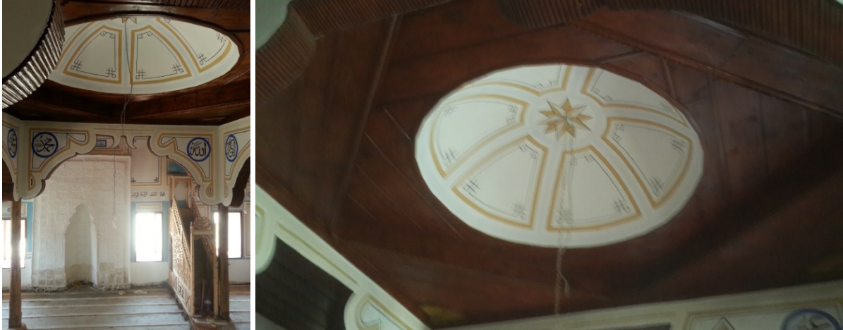
Şekil 6. Camide kubbeli döner eksenli bindirme tavandan görünüm (Kaynak: Yazarlara ait fotoğraf arşivi, 2016).
