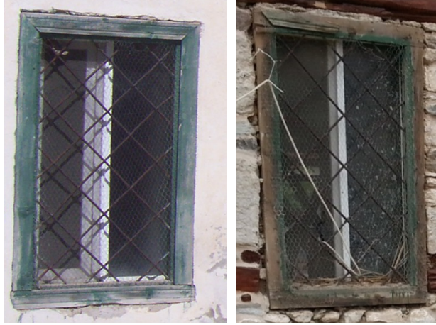
Şekil 3. Pencere metal geçmeli parmaklarının fotoğrafları (Kaynak: Vakıflar Genel Müdürlüğü Arşivi, 2013; Yazarlara ait fotoğraf arşivi, 2016).
