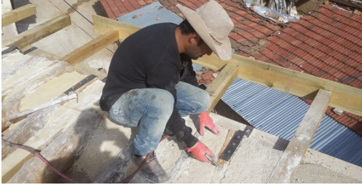
Şekil 14. Çatıda saçakların yenilenmesi ve hatıllarda çelik profiller ve bulonlar ile birleşim detayını gösterir fotoğraf (Kaynak: Yazarlara ait fotoğraf arşivi, 2016).
