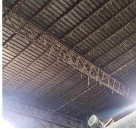
Şekil 7. Söndürme sistemi olmayan pamuk işletme tesisi
