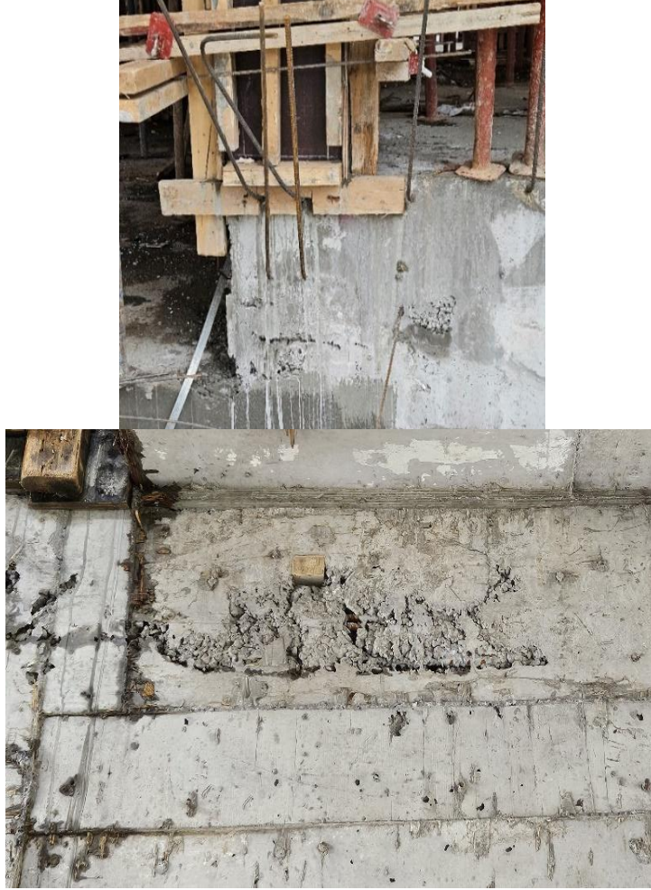
Şekil 6: Kalıp sökülmesi ile ortaya çıkan petek dokusu sorunu (Yazar tarafından üretilmiştir, 2024)
