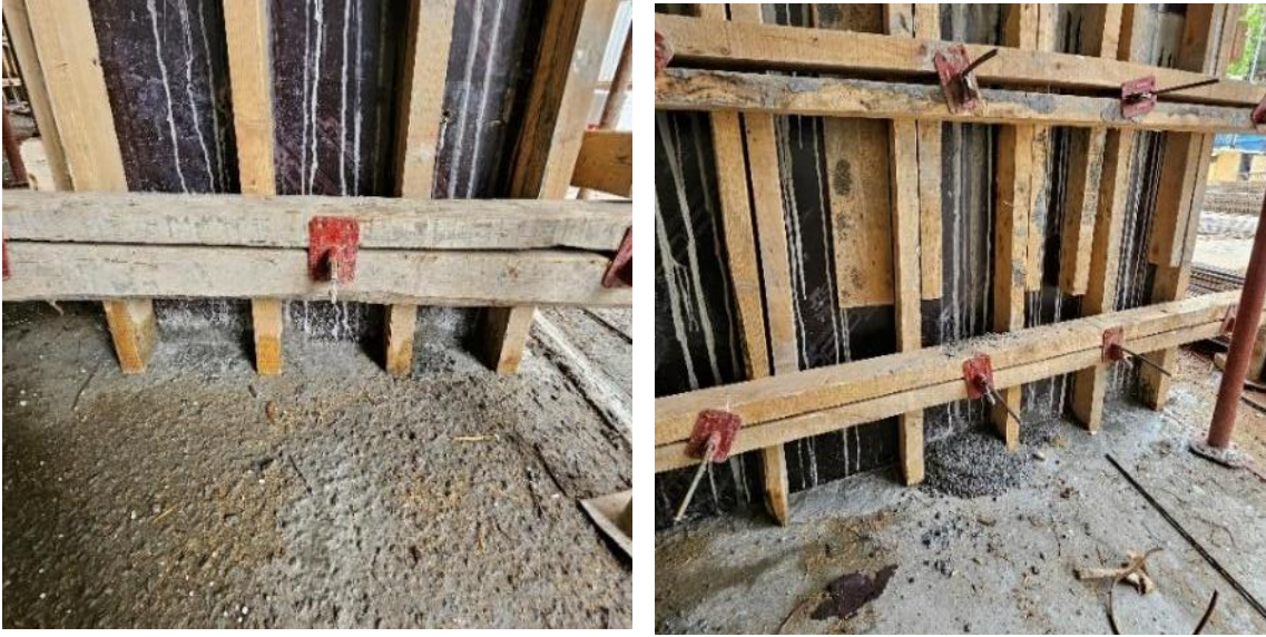
Şekil 5: Kalıptan beton sızma görseli (Yazar tarafından üretilmiştir, 2024)
