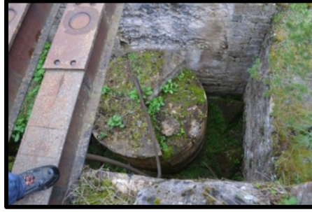
Şekil 56: Çukurçay'da telleri geren manivelanın beton ağırlık sistemi.
