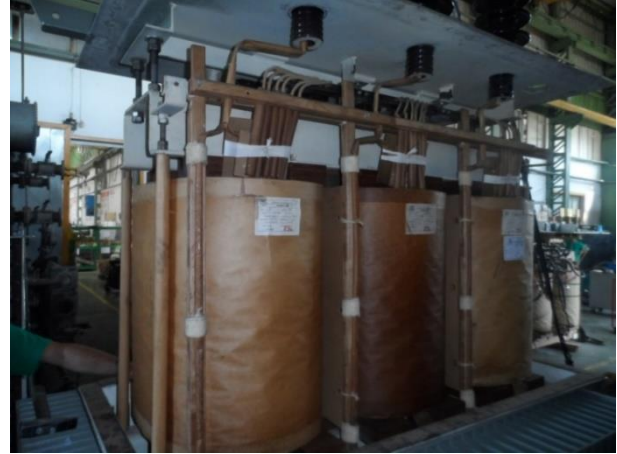
Şekil 1. İncelenen transformatör (Studied transformer)
