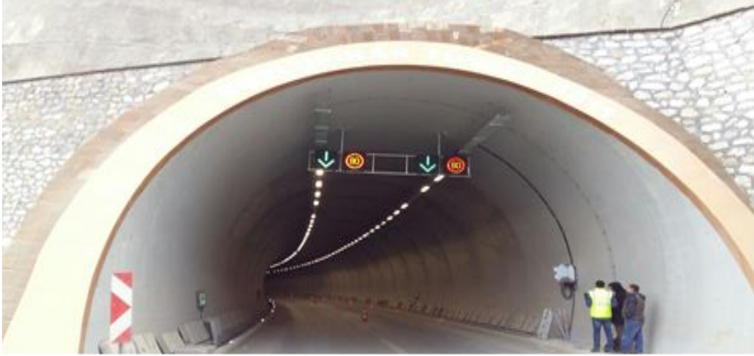
Şekil 5. LED Armatür İle Tünel Aydınlatması
