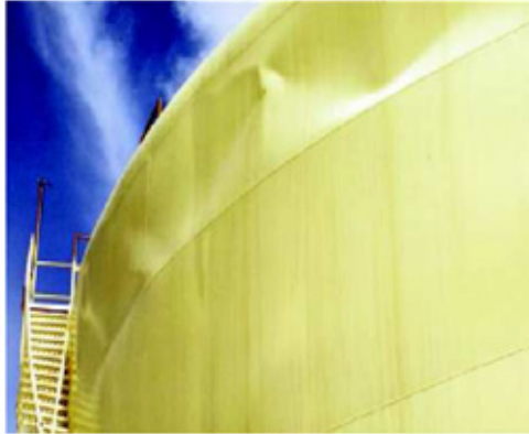
Şekil 1. Silindirik çelik tankın deprem hasarı
