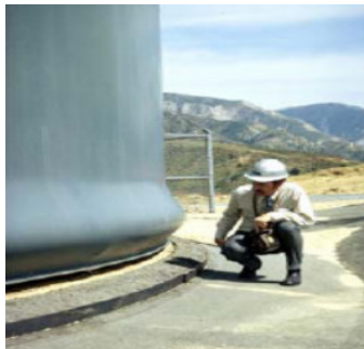
Şekil 2. Fil ayağı burkulması
