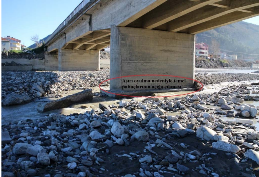
Şekil 3. Çatalzeytin köprü ayaklarında aşırı oyulma nedeniyle temel pabuçlarının açığa çıkması (Disclosure of footing of Çatalzeytin bridge pier due to the excess scouring)
