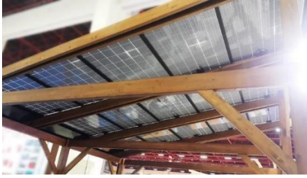
Şekil 4. Çatı İle Bütünleşik Fotovoltaik Paneller
