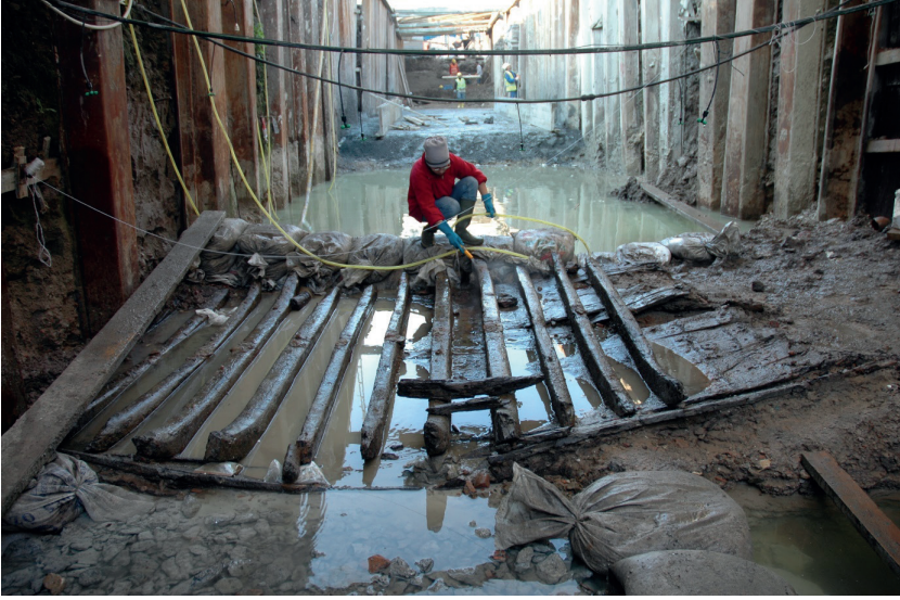
G. 2: Batığın ilk durumu ve temizlik çalışması (İÜ Yenikapı Batıkları Projesi Arşivi)
