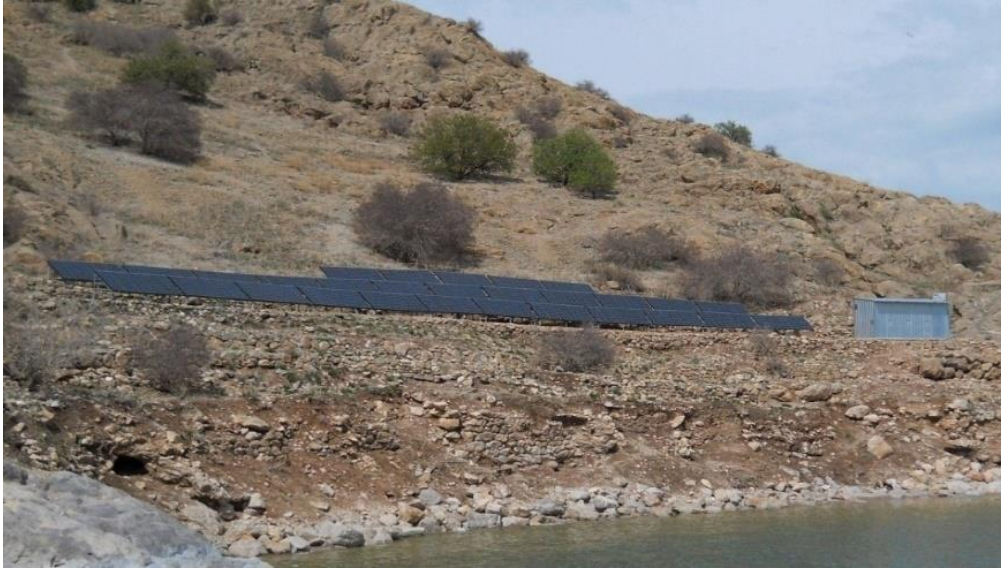
Şekil 2. Akdamar Adası güneş enerjisi uygulaması
