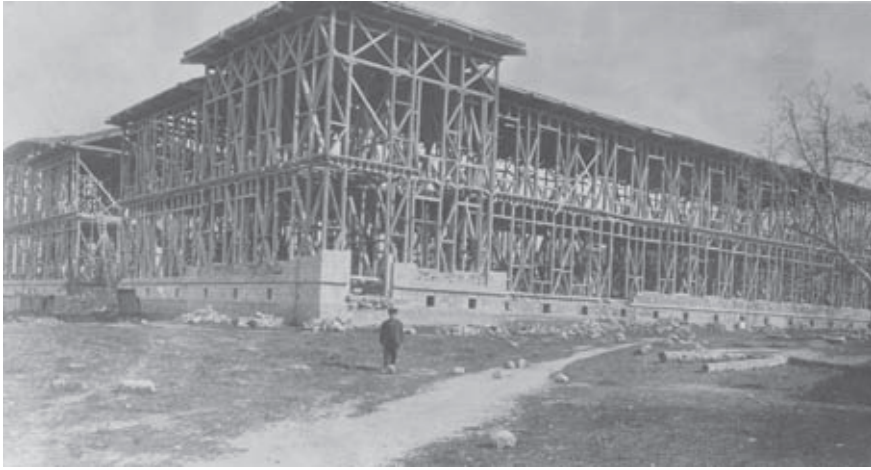
Ek 1: 1915'te yapımına başlanan Denizli İdadisi binası (bugünkü Denizli Lisesi C Blok)
