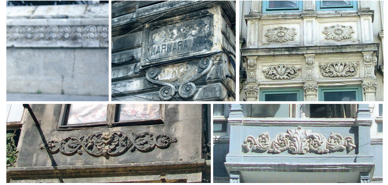
Şekil 14. Yapay taş bezeme örnekleri (soldan sağa): (üst sıra) bezeme örgesi, Hıdıva Sarayı bahçe duvarı (Bebek, düzenleme A. Lasciac, 1900-1901), isim levhası, Marmara Han (Beyoğlu Kurabiye Sokak 1, 1893), pencere altı ve üstünde bezeme levhaları, Apparts. Couteau (Beyoğlu İstiklal Caddesi 135, 1905'ten önce), (alt sıra) apartman (Beyoğlu Sakızağacı Caddesi 5, 1905'ten önce) ve apartman (Beyoğlu İstiklal Caddesi 52, 1874).
