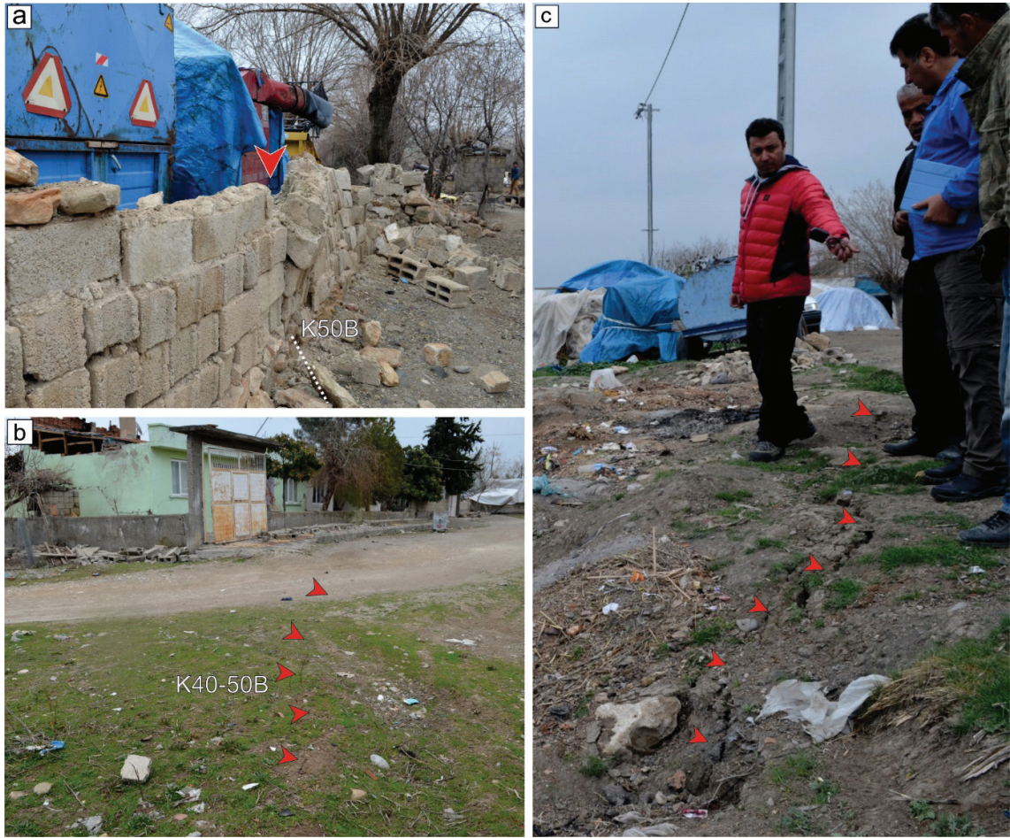
Şekil 5. 2 Mart 2017 depremi sonrası (a) Akdamar köyünde gözlenen sağ yanal doğrultu atımlı faylanmayı işaret eden çizgisellik, (b) Samsat ilçe merkezi ve (c) Taşkuyu köyünde gözlenen yüzey çatlakları.
