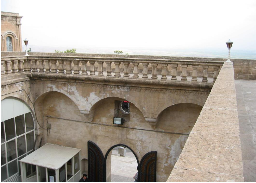
Şahtana Konağı Kullanım Hataları Sonucu Oluşan Tahribat-2009
