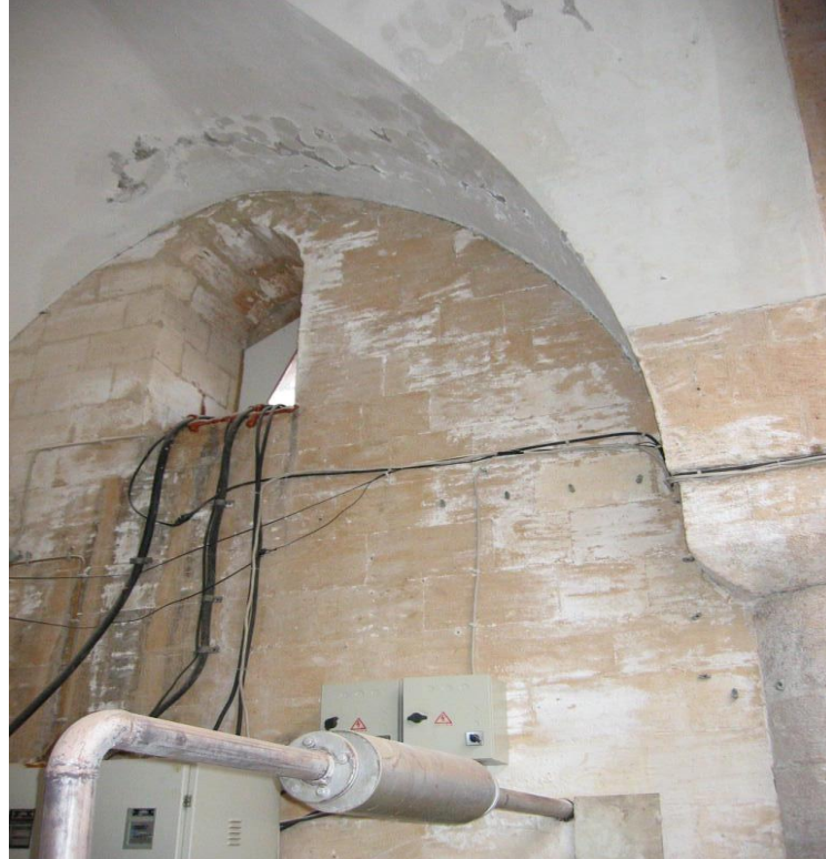
Şahtana Konağı'nın Su ve Neme Bağlı Devam Eden Tahribatı
