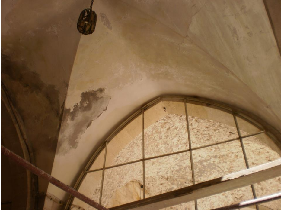
Şahtana Konağı Tahribat Detayı-2011
