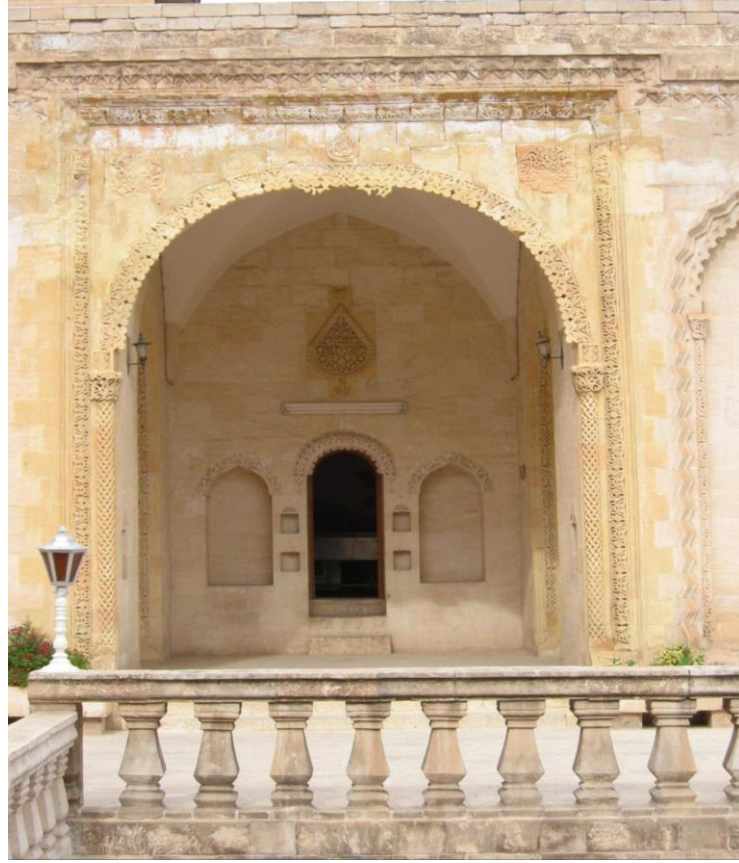
Şahtana Konağı'nın Su ve Neme Bağlı Devam Eden Tahribatı
