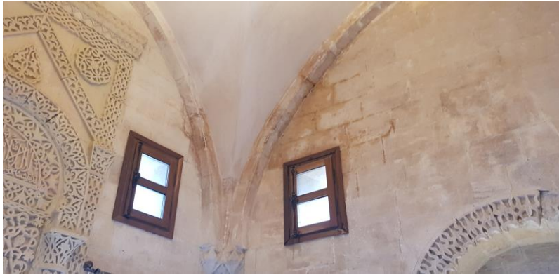
Şahtana Konağı Odalarındaki su ve Neme Bağlı Devam Eden Tahribatlar
