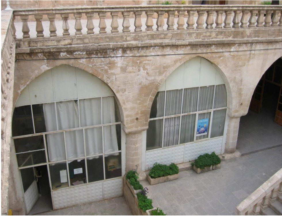
Şahtana Konağı Kullanım Hataları Sonucu Oluşan Tahribat-2009
