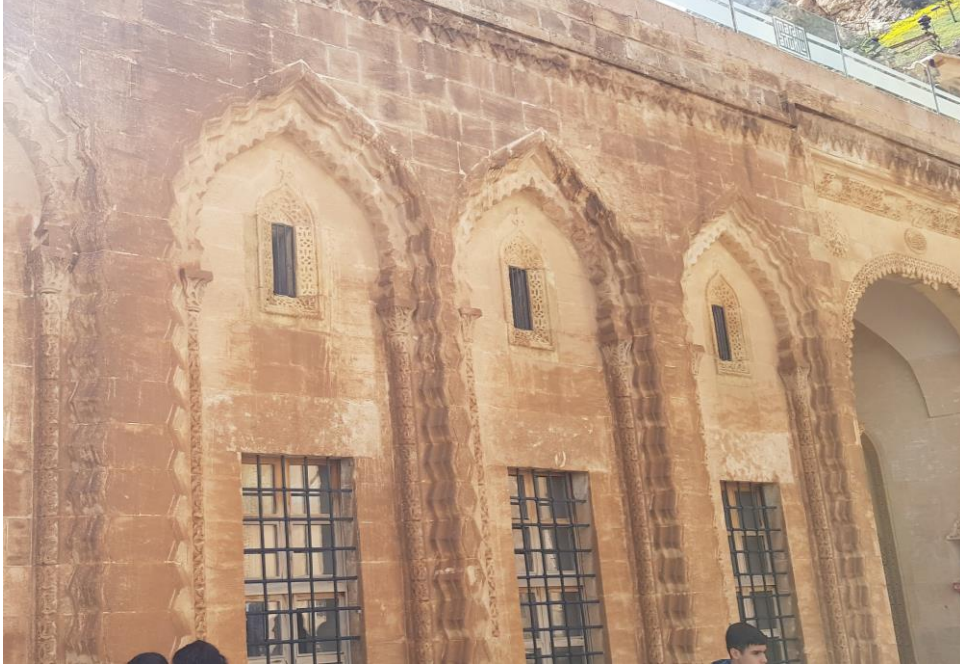
Şahtana Konağı Hava ve Trafik Kaynaklı Cephe Kirliliği
