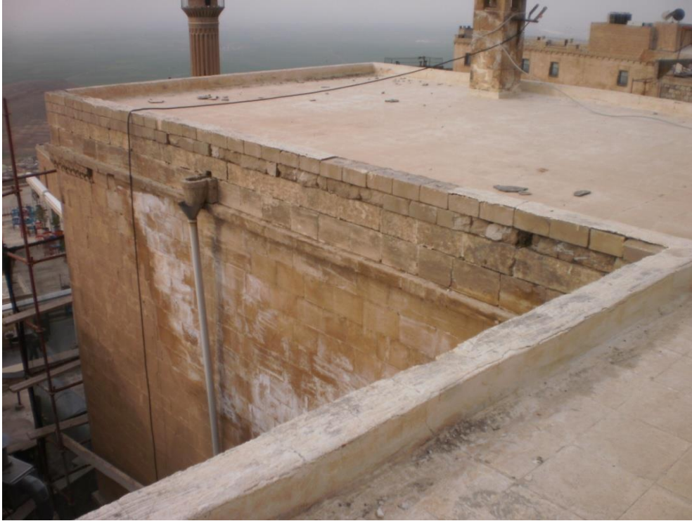
Şahtana Konağı Tahribat Detayı-2011
