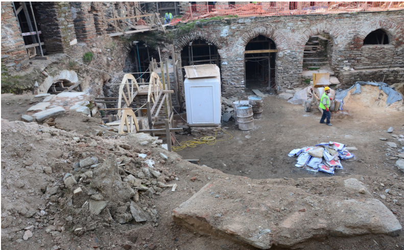
Fot.13- Üst katın güneybatı köşesinde "L" şekilli payelere ait izler.
