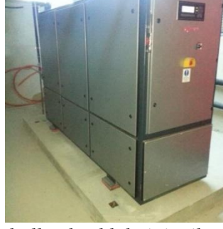
Şekil 6. SehaYapı’da kullanılan blok tipi mikro kojenerasyon ünitesi
