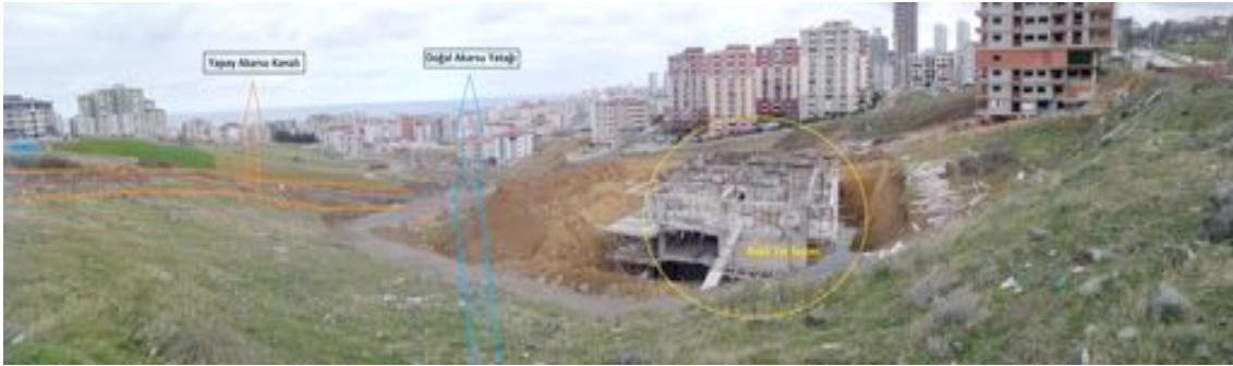
Fotoğraf 4. Doğal Akarsu Yatağının Yapay Kanala Alınması. Doğal Yatak İçinde Başlayan Konut İnşası, İlçede Olası Kuvvetli Oraj Hava Durumunda Yapay Kanalı Patlayıp Yerleşmelerin Taşkına Uğramasına Sebep Olabilir.
