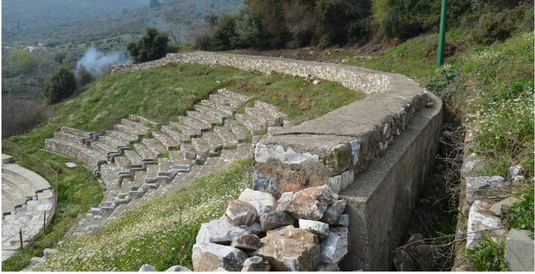
Şekil 18. Üst cavea oturma sıralarının bütünlenmesi ve drenaj kanalı (Kafa Duran, E. Kişisel arşiv, 2017)
