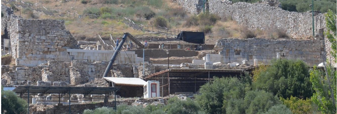
Şekil 27. Metropolis Stoa duvarı tamamlandıktan sonra cephe görünümü (Kafa Duran, E. Kişisel arşiv, 2018)
