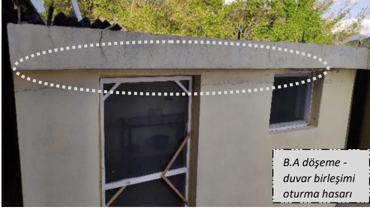
Şekil 13 (devam). Farklı Zemin Oturmalarına Bağlı Hasarlar
