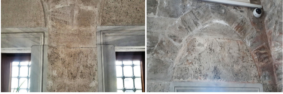
G. 13. Türbede iki pencere arasındaki çatlak (sol) (Emre Kışalı, 2019) ve Türbede pencere üzerindeki tuzlanmalar (sağ) (Safa Meral, 2019)
