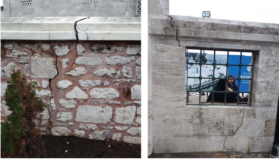
G. 12. Bahçe duvarlarında tespit edilen çatlaklar (Safa Meral, 2017)
