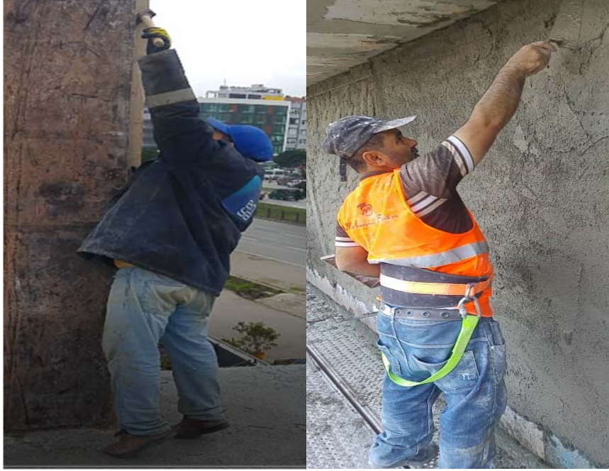
Şekil 4. Üst seviyede gerçekleştirilen Kalıp Sökme ve Sıva Yapma işleri ("Dismantling of Molds" and "Mortar" works performed in the Top working position)
