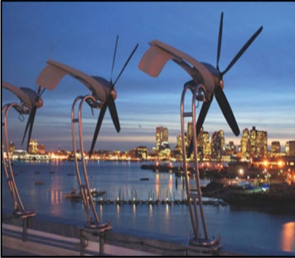
Şekil 3. Boston Logan Uluslararası Havalimanında ofis binasına monte edilmiş entegre rüzgar türbinleri [27].
