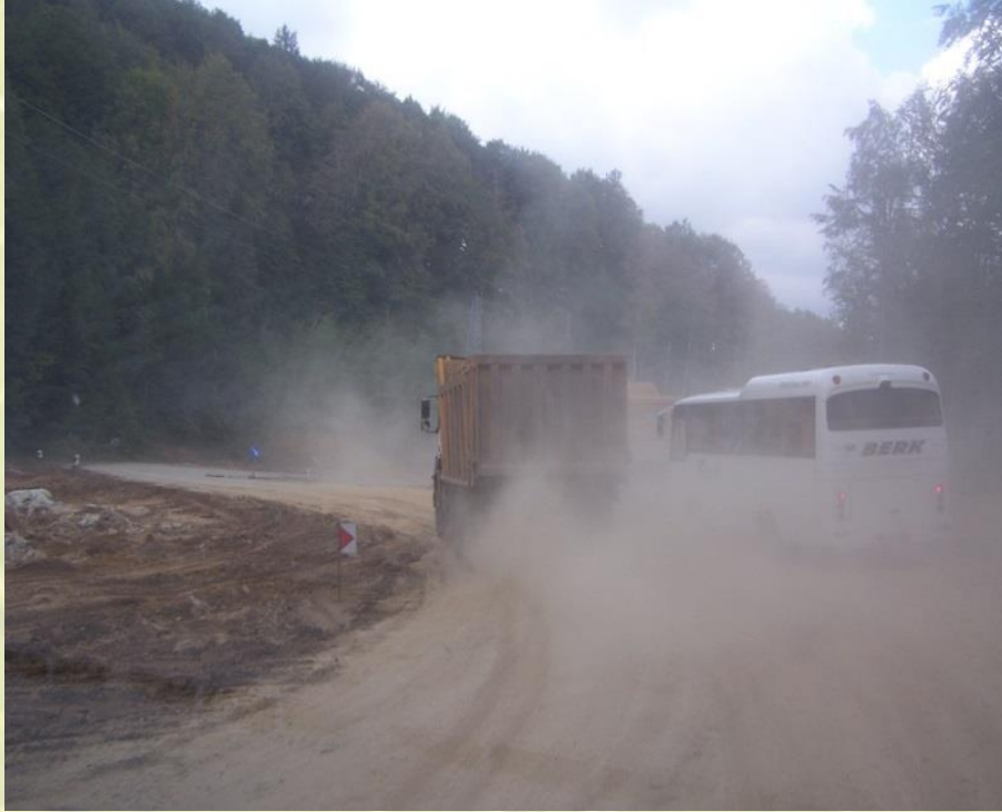
Şekil 6: Yenice-Demirköy yolunun yapımı sırasında kamyon trafiğinden oluşan toz
