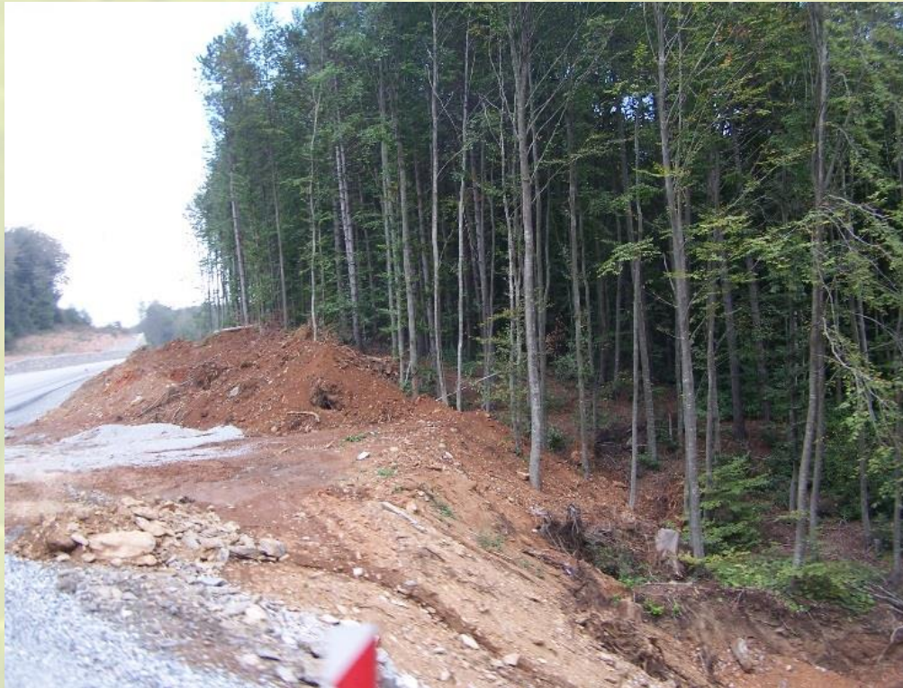
Şekil 9: Yenice-Demirköy yolunun yapımı sırasında düzensiz yağma sonucunda ağaçların toprak altında kalması
