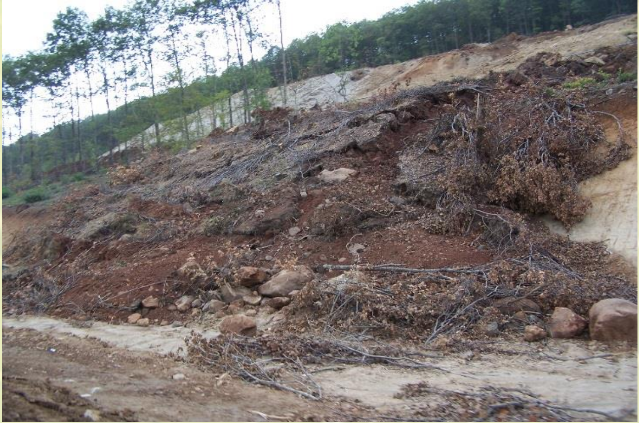
Şekil 10: Yenice-Demirköy yolunun yapımı sırasında düzensiz yağma ve yığılan materyalin göçmesi
