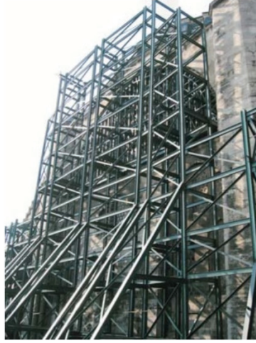
Şekil 1 - Mihrimah Sultan Camii mihrap cephesinde 1999 Kocaeli depremi sonrası kurulan çelik askı sistem ile güçlendirme çalışması [19].
