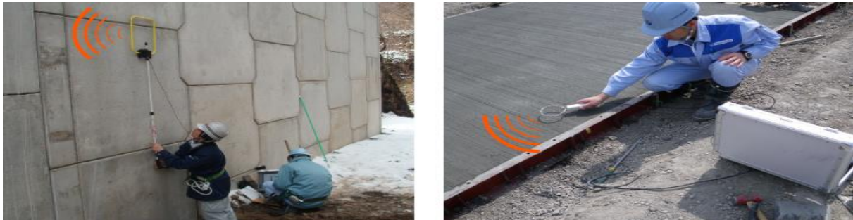
Şekil 4. Betonarme yapılarda şekil değişiminin RFID ile takibi (Taiheiyu Cement Corporation) [12]
