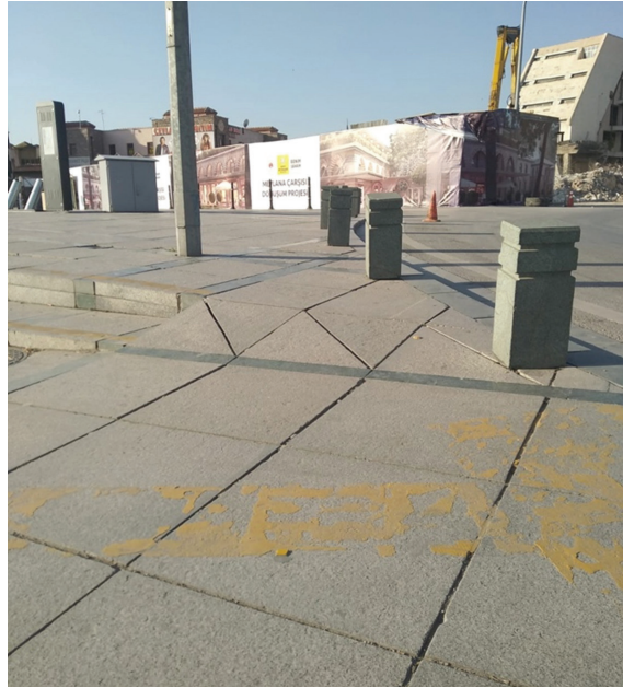
Fotoğraf 6: Mevlana Meydanından Aziziye Camisine gidiş güzergahı, engelli rampası ve görme engelliler için konulmuş ancak tahrip olmuş sarı zemin uygulaması
