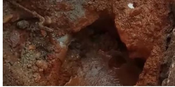
Şekil 8. Tespit edilen boru sızıntıları için örnek
