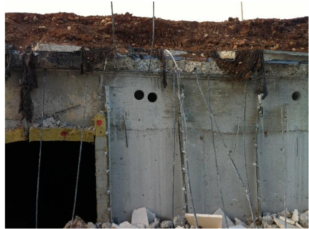
Şekil 8 Binanın göçen kısmından alınmış karot numuneler
