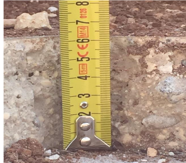
Şekil 10 Döşeme içerisinde 5 cm olması gereken koruma betonu
