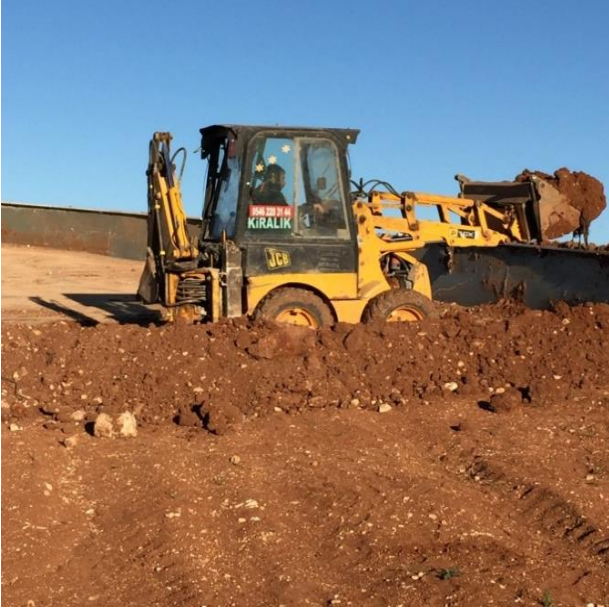
Şekil 16 Çatı döşemesine serilen toprağın göçme sonrası tahliyesi
