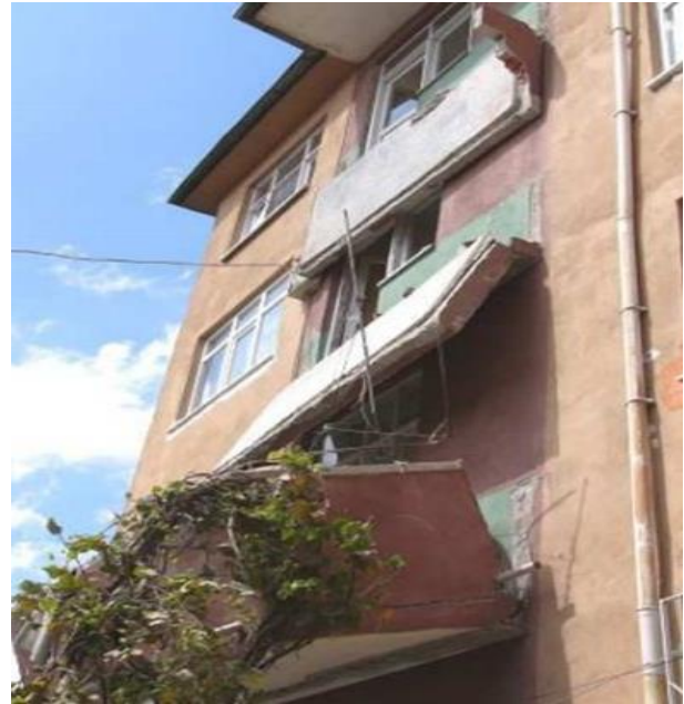
Şekil 4 Betonarme bir binanın göçmüş balkon döşemeleri.
