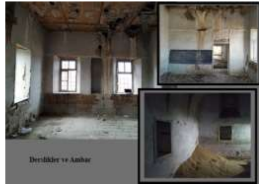
Şekil 19. Uluğağ Rum Okulu dersliklerinde yapısal bozulmalar (Figure 19. Structural deterioration in the classrooms of Uluğağ Greek School (İlknur ACAR ATA,2019))
