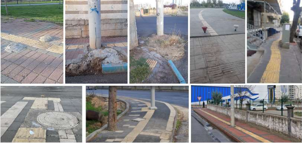
Şekil 9. Hissedilebilir yüzeylerin üzerinde ya da yakınındaki engeller
