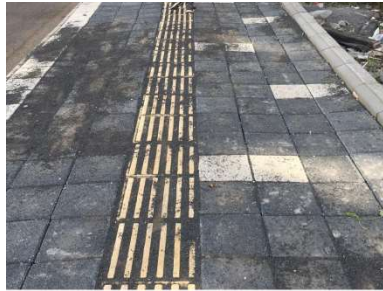
Şekil 29. Kaldırımdaki bozulmalardan etkilenen hissedilebilir yüzey
