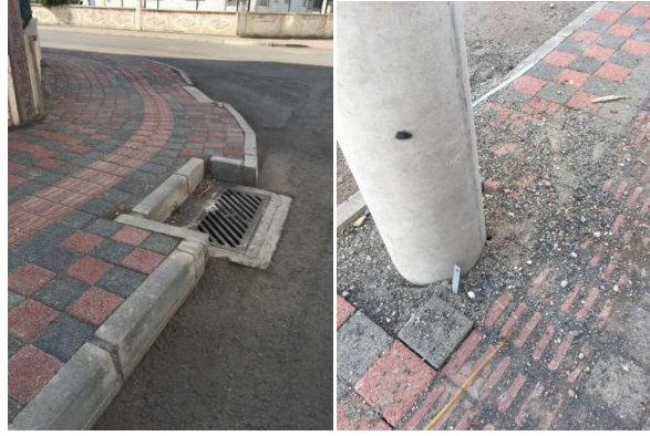
Şekil 30. Mazgal ve aydınlatma direği yakınından geçen hissedilebilir yüzey
