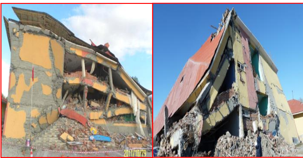
Şekil 2. Perdeli Yapı Deprem Hasarları (Doğan, 2013)
