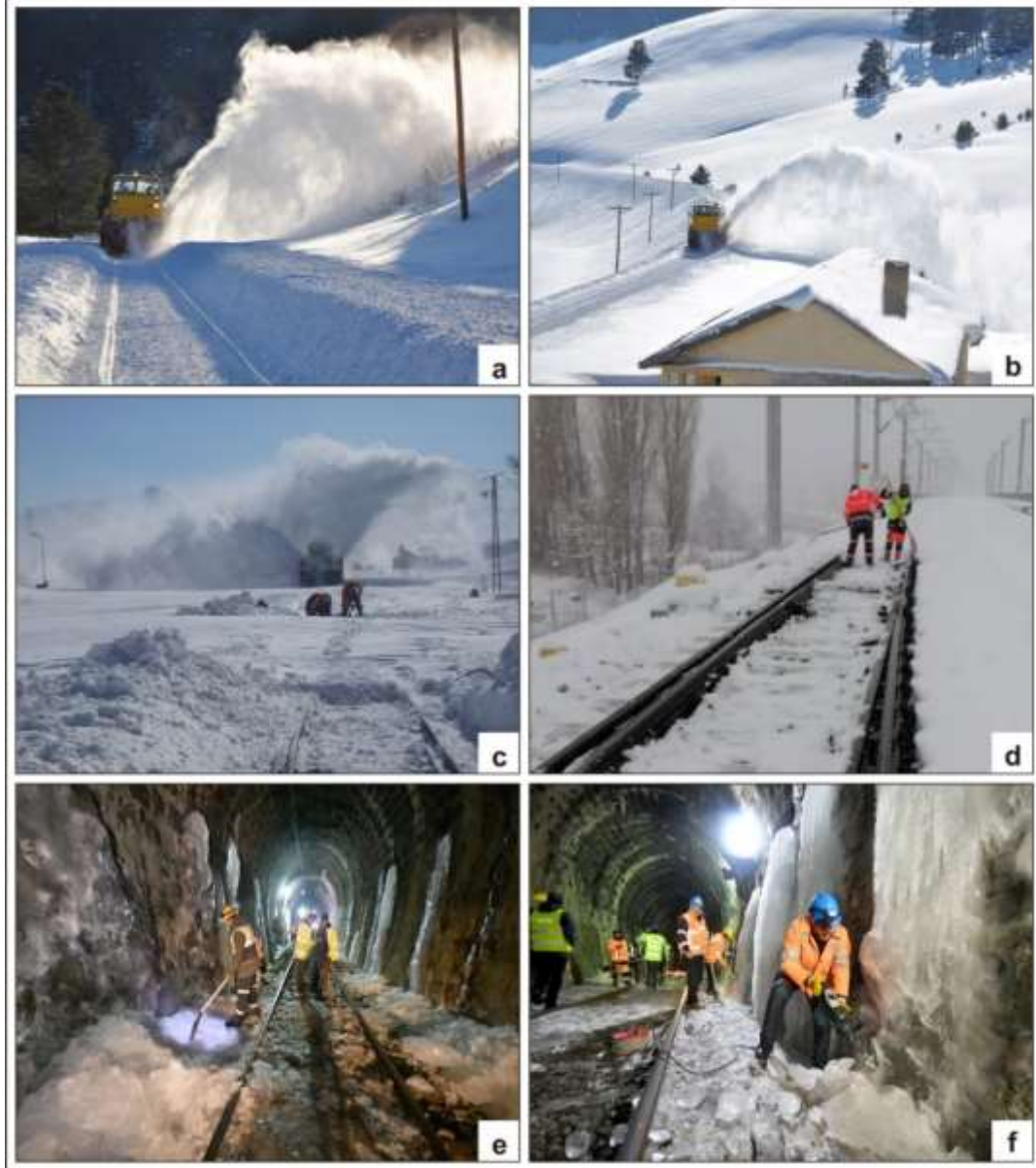
Şekil 1. Demiryolu hatlarında kar temizleme çalışmaları (a, b: Ana hatlarda kar temizleme çalışması, c: Ana hat ve makasta kar temizleme çalışması, d: Makasta kar temizleme çalışması, e, f: Tünelde buz temizleme çalışması) [12, 13 ve 14].
