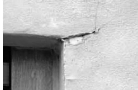
b) Hatalı uygulamadan kaynaklı çatlak
